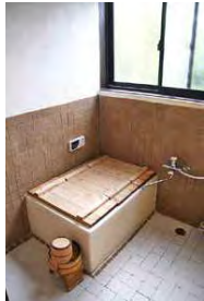
完成した浴室。内壁はアスファルトフイーディングで防水し、下はタイル、上は漆喰で仕上げた
