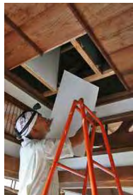
薪ストーブの煙突を設置するため、天井をはがし、屋根裏にケイカル板を張る
